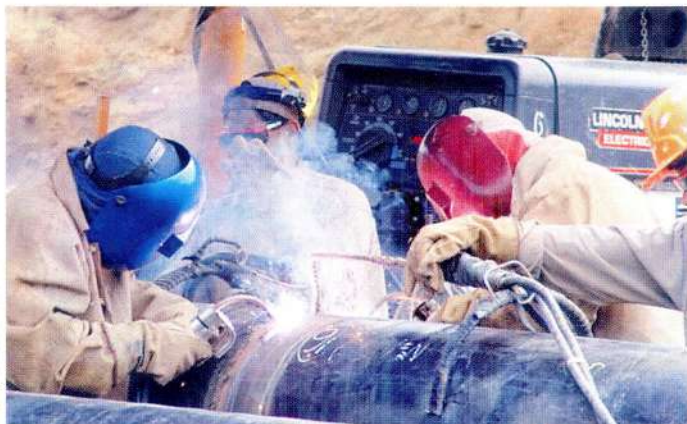
Transportadora de Gas del Perú S.A.
